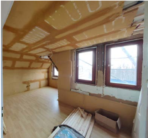
In der Bauphase sind die naturbo Deckenheizungsplatten mit aufgedrucktem Verlauf der Heizrohre gut zu erkennen.
